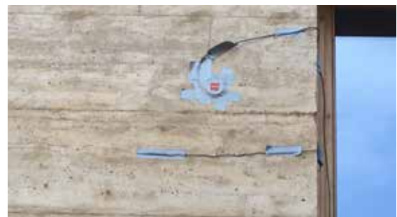
Figura 4. Instalación exterior de los equipos de medida en el muro estudiado. (Fuente: la autora).
