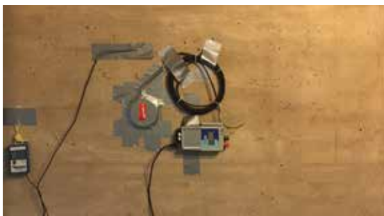
Figura 3. Instalación interior de los equipos de medida en el muro estudiado. (Fuente: la autora).
