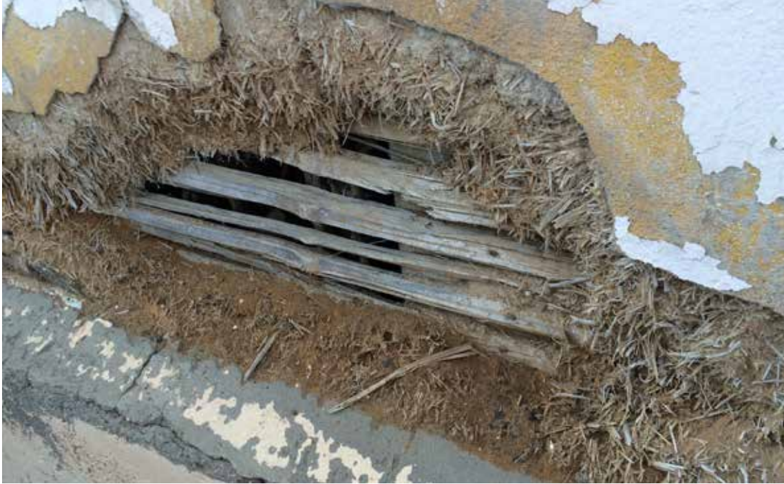
Figura 7. Disgregación de revoques en Iglesia Santa Rosa de Lima, 2016. Fuente: Propia.
