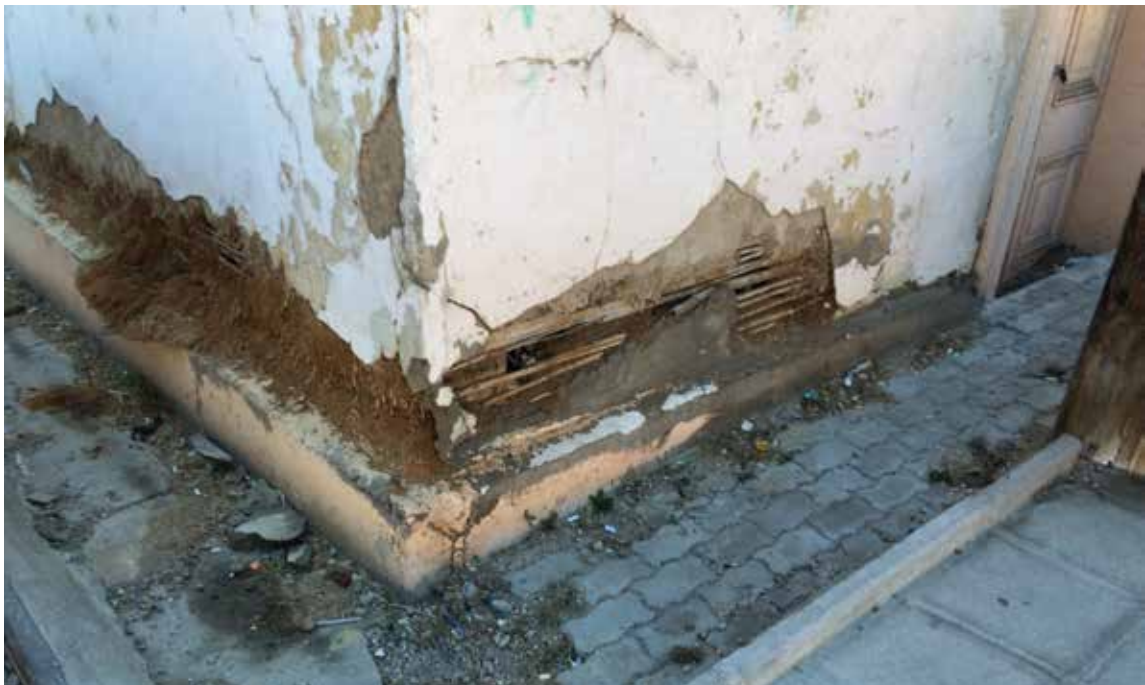
Figura 6. Disgregación de revocos en Iglesia Santa Rosa de Lima, 2016. Fuente: Propia.
