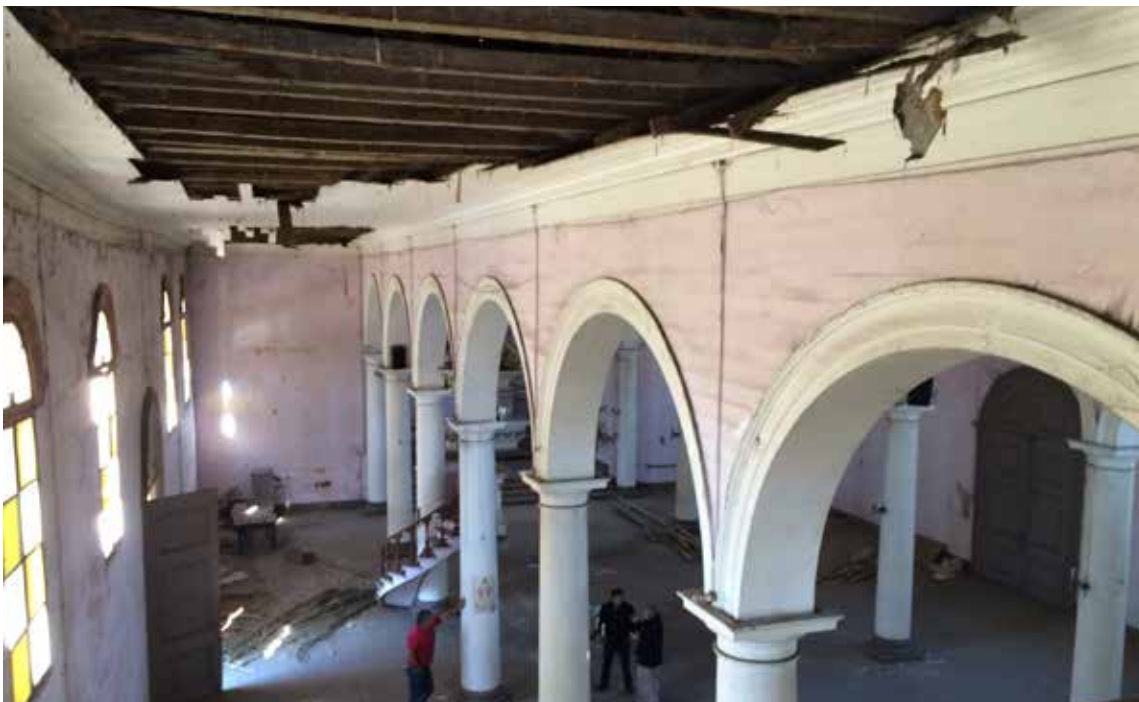
Figura 8. Colapso de cielo en nave lateral en Iglesia Santa Rosa de Lima, 2016. Fuente: Propia.
