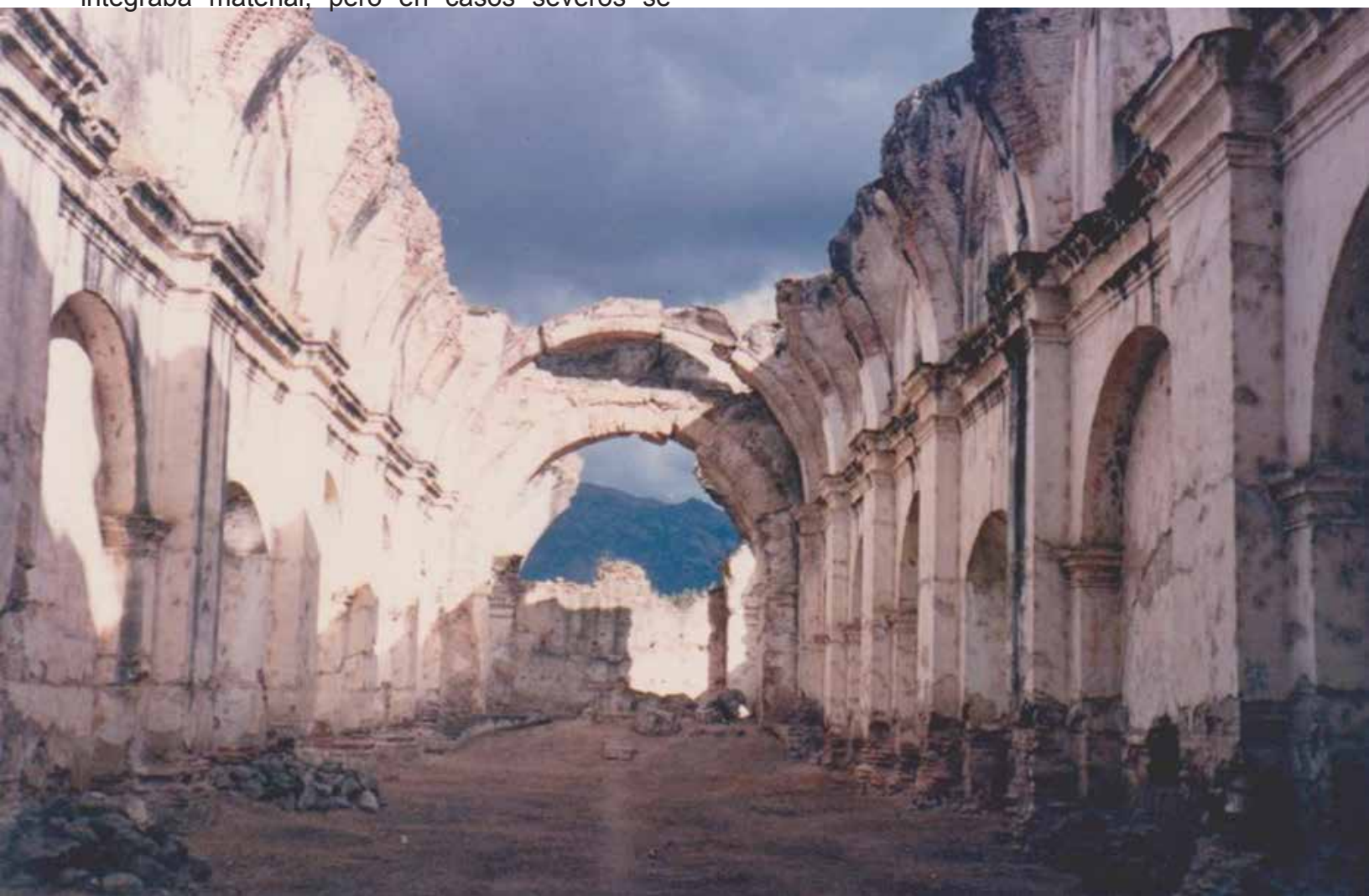
Figura 3. Interior del templo arruinado de Chiquimula de la Sierra, destruido en 1765. Recuperado del álbum fotográfico, de M. A. Ubico Calderón, 1990, Guatemala.
