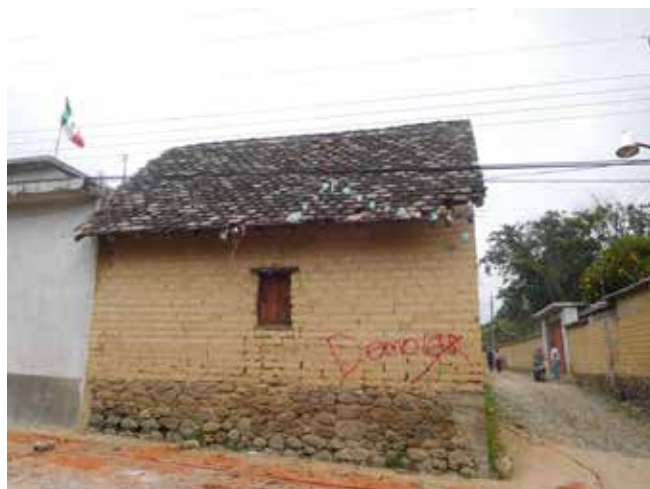
Figura 3. Identificación de vivienda de adobe clasificada para demolición. Metepec, Ocuituco. Fabiola B. Herrera Rivas. 23 de septiembre de 2017.
