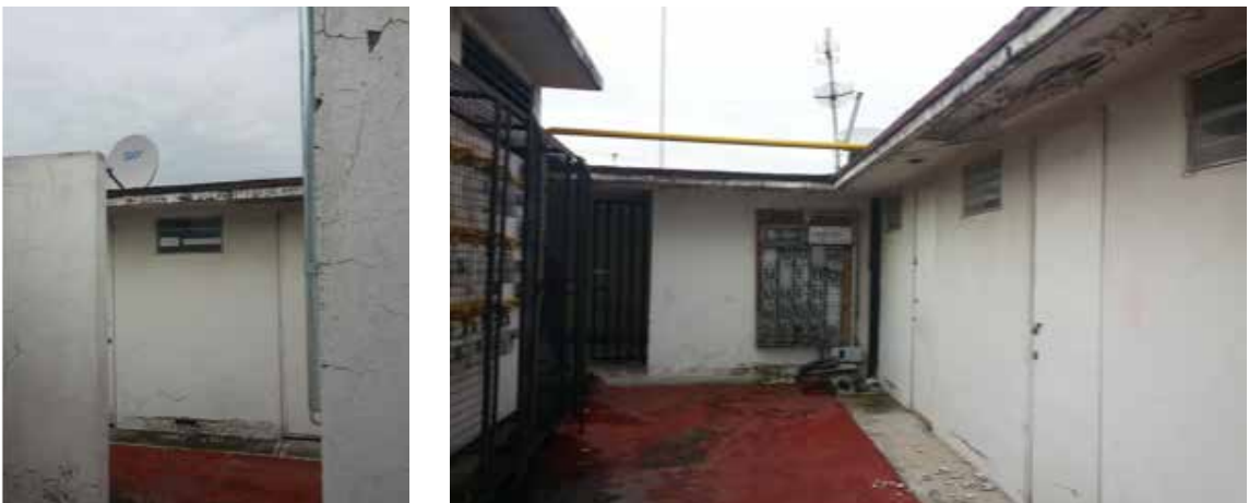
Figura 13. Cuartos de azotea del Edificio Presidente Juárez, Segunda Sección; desprendimiento de aplanados, encharcamientos, filtraciones; acceso controlado, uso que les destinan como área de almacenamiento. FUENTE. [Fotografías de Michelle Reza Flores]
