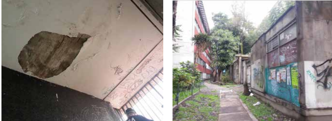
Figura 3. Deterioro al interior y exterior de los inmuebles. FUENTE. [Fotografías de Michelle Reza Flores]. (Tomadas en los diversos recorridos de campo, muestran el deterioro de interiores y exteriores de los edificios), 2017.
