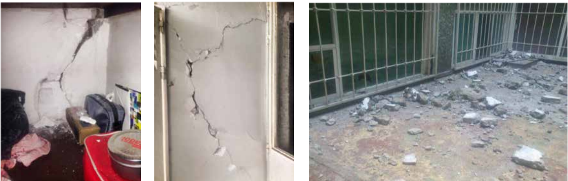
Figura 14. Daños ocasionados por el sismo mayo 2014; interiores de vivienda; planta baja en Edificio tipo "A". FUENTE. [Fotografías de Michelle Reza Flores]
