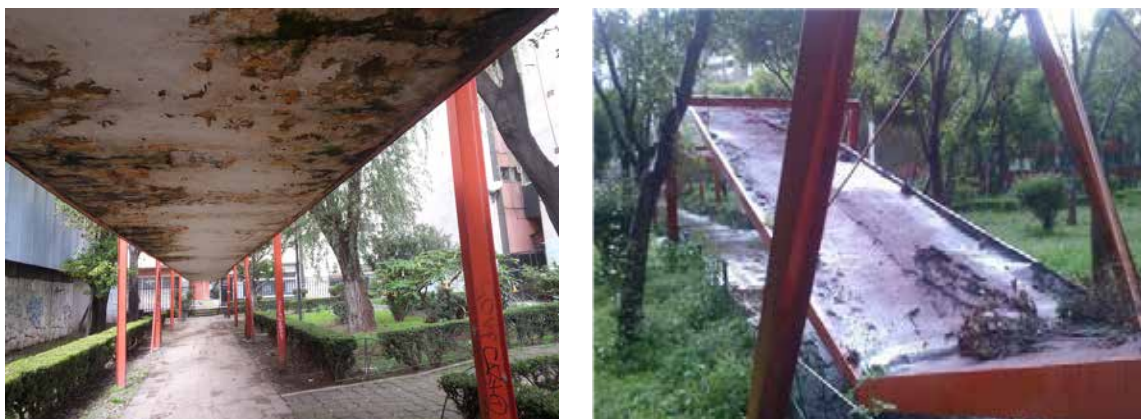
Figura 4. Fuente: [Fotografía Izquierda de Michelle Reza Flores]. (Pasos a cubierto dañados por filtraciones, recorrido de campo), 2017. Fotografía de la derecha. extraída de "Vivir en Tlatelolco" periodismo comunitario. Recuperada en: http://vivirtlatelolco.blogspot.com
